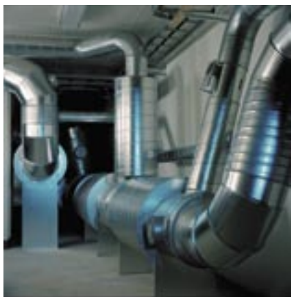
Сегмент вентиляционной системы.
